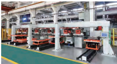
▲图1 智能化车间生产线现场
