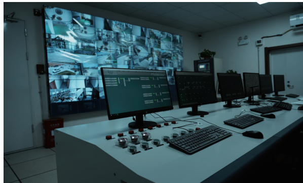
▲图 2-1 车间数据中心
