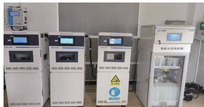
▲图 2-5 废水污染监测与管控系统
