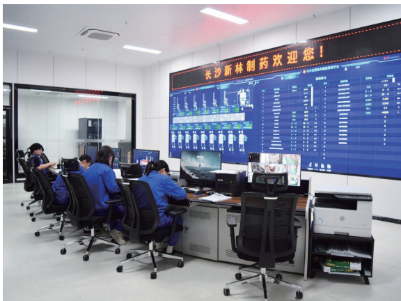
▲ 图 2-1 配方颗粒中央控制室
