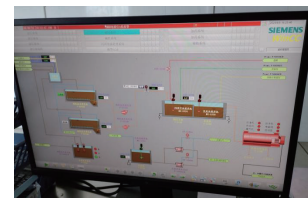
污水处理自动化控制系统
